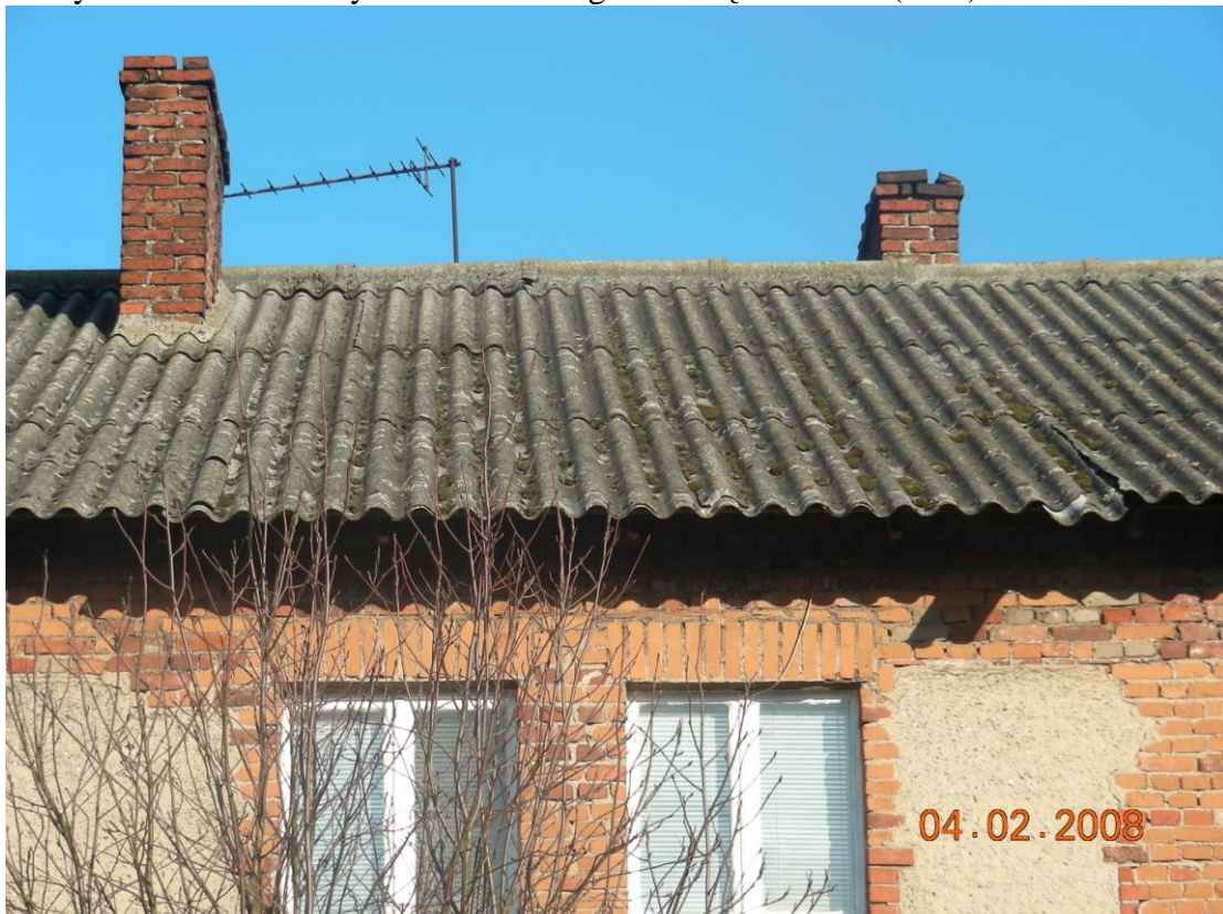
Pokrycie azbestowe budynku mieszkalnego w Święciechowie (fot.4)
